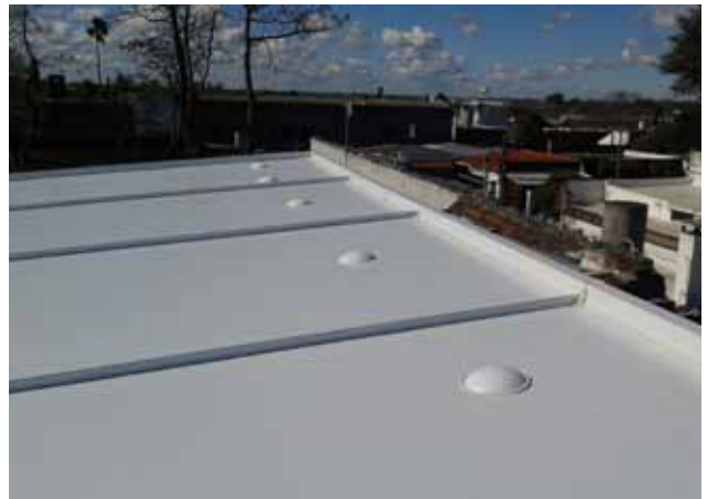
Anclaje pasante visto con tapa de polipropileno.
